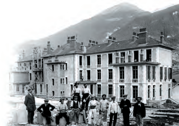
Construction de la caserne et de l'hôpital militaire de Modane Ouvriers italiens Coll. Muséobar – Musée de la frontière (Modane)
